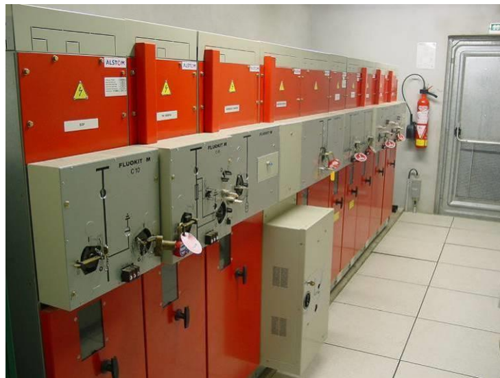
Intérieur d'un poste de livraison
